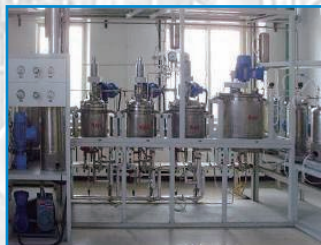
丁苯橡胶模试装置
