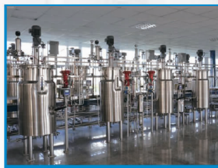
燃料乙醇试验装置
