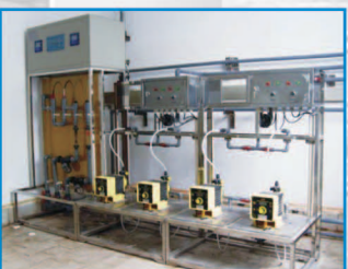
污水处理模试装置
