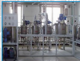
丁苯橡胶模试装置
