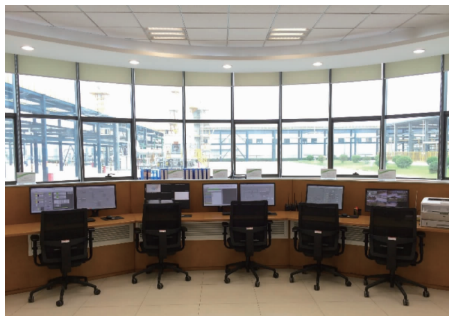
霍尼韦尔洛阳建成了火炬测试中心，可以测试火炬在实际工况下的燃尽率。
