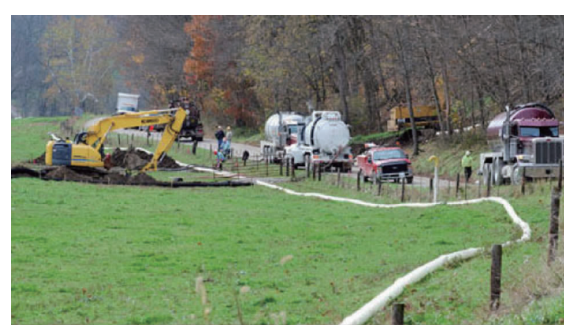
图 2 美国马塞勒斯页岩气田地地面铺设的塑料管道
