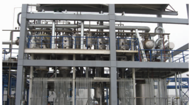
高温尾气净化、余热利用
