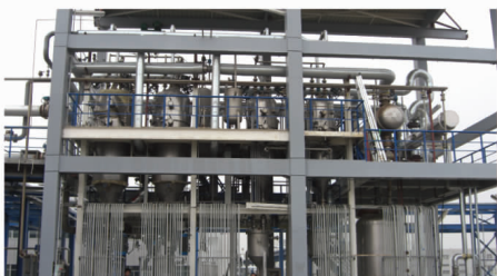
高温尾气净化、余热利用
