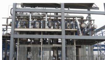
高温尾气净化、余热利用
