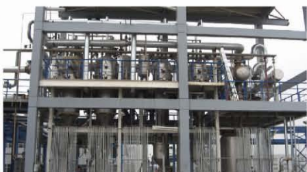
高温尾气净化、余热利用
