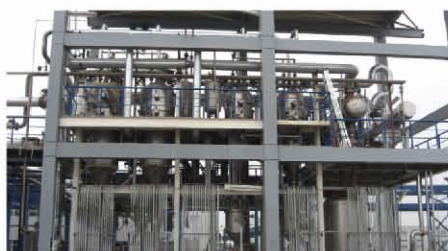
高温尾气净化、余热利用
