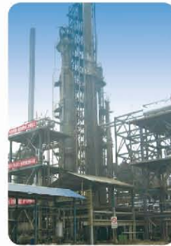
中国石油化工股份有限公司西安石化分公司常压塔
