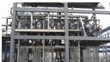
高温尾气净化、余热利用
