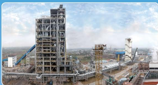
湖北煤气化项目装置
