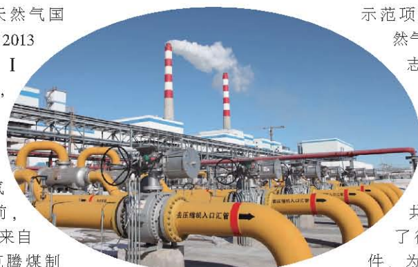
大唐煤制天然气输气首站管道
