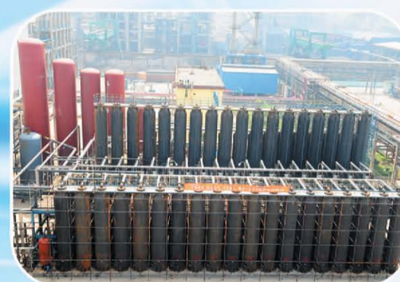
▲ 山东兖矿集团鲁南化肥厂年产10万吨变压吸附提纯CO装置
