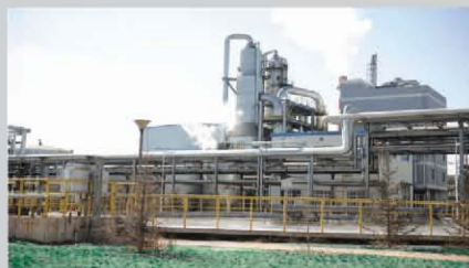
领先的ZLD 污水零排放装置 (神华煤制油高含盐污水零排放项目)
