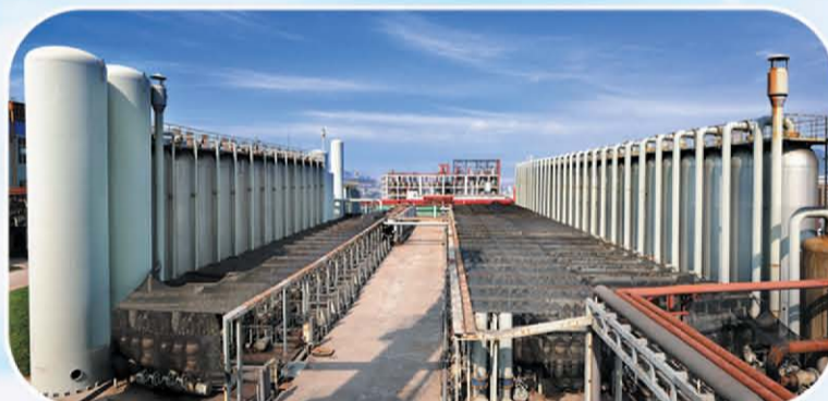
▲ 晋煤集团山东明水化肥厂年产30万吨甲醇变压吸附脱碳装置
