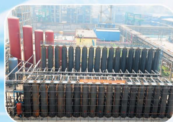
▲ 山东兖矿集团鲁南化肥厂年产10万吨变压吸附提纯CO装置
