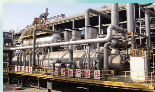
10万吨硫回收装置—主炉系统
