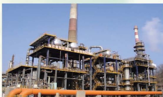
4万吨硫回收装置全貌
