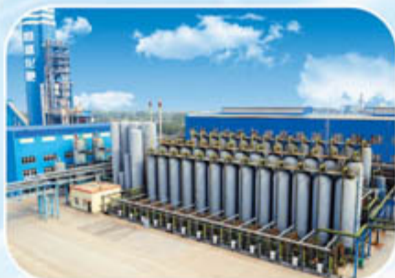
▲ 江苏恒盛化工有限公司年产30万吨合成氨50万吨尿素变压吸附脱碳装置
