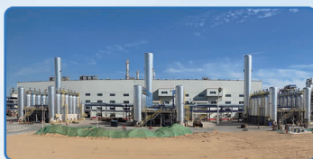
煤制氢变压吸附装置
