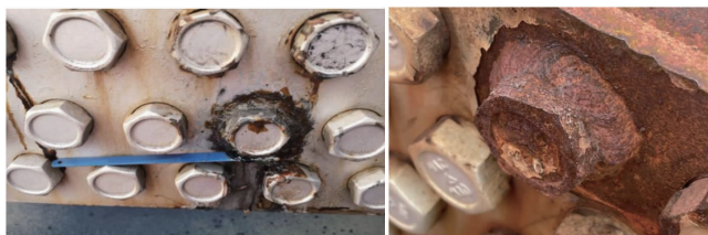
图 1 联合装置内空冷式换热器丝堵泄漏
