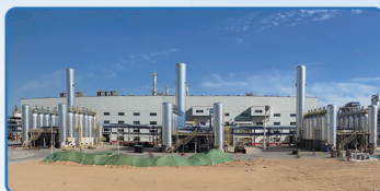
煤制氢变压吸附装置
